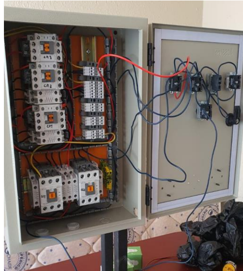
Fig. 56. Instauración de tablero de control
