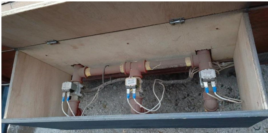
Figura 58 Caja de electroválvulas
