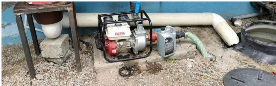
FIGURA 34 INSTALACIÓN DE TUBERÍA PVC DE 5" DESDE EL GENERADOR AL TANQUE DE RESERVA DE AGUA (FUENTE: AUTOR)
