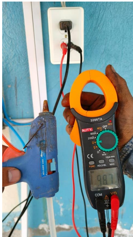
FIGURA 43 CAÍDA DE VOLTAJE CON CARGA DE 12W - 98.7V (FUENTE: AUTOR)
