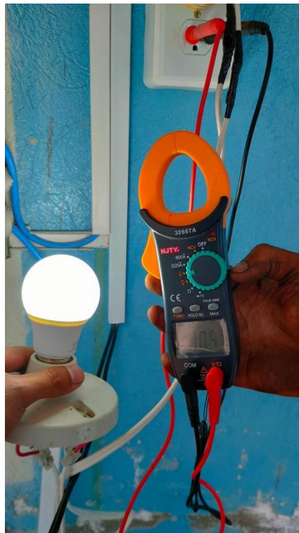
FIGURA 45 CAÍDA DE VOLTAJE CON CARGA DE 8.5W - 105V (FUENTE: AUTOR)
