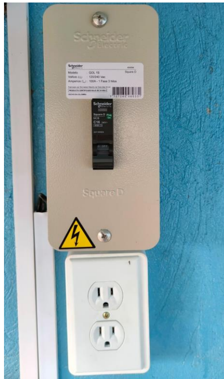
FIGURA 36 PROTECCIÓN ELÉCTRICA DE 16A Y TOMACORRIENTE MONOFÁSICO (FUENTE: AUTOR)
