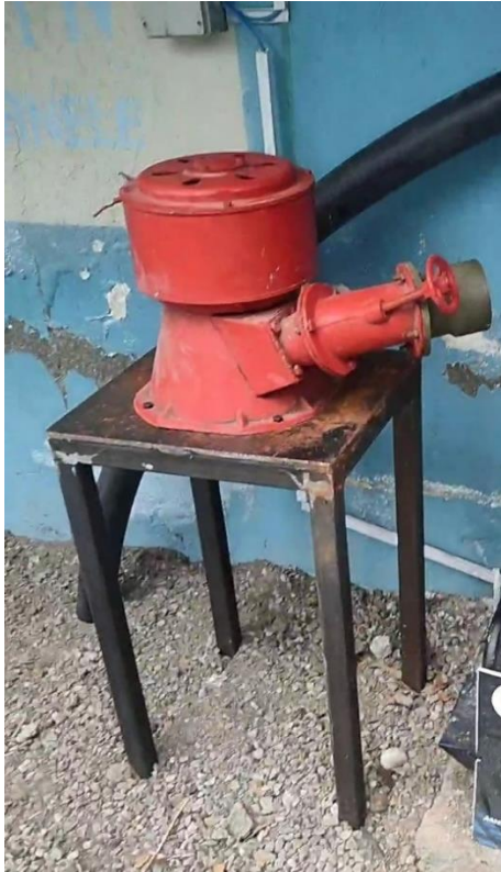
FIGURA 31 GENERADOR MONTADO SOBRE LA BASE METÁLICA (FUENTE: AUTOR)
