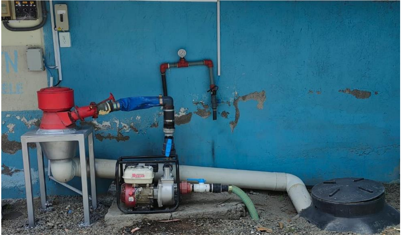
FIGURA 37 PICO-GENERADORA HIDROELÉCTRICA INSTALADA (FUENTE: AUTOR)
