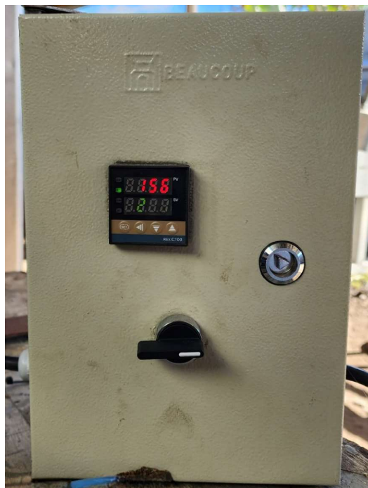
Cajetín de conexiones eléctricas del sistema calentador
