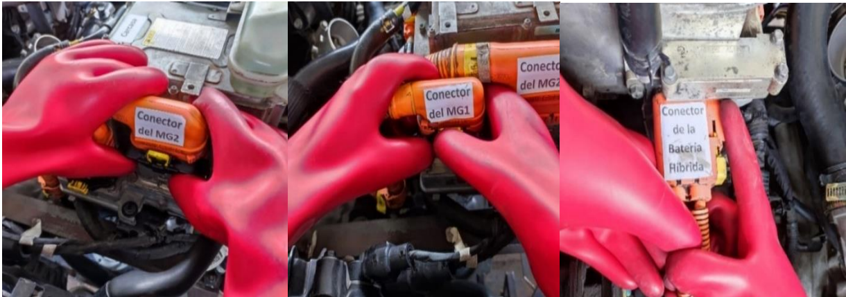
Anexo 5 figura 7 Conectores de cables de alta tención
