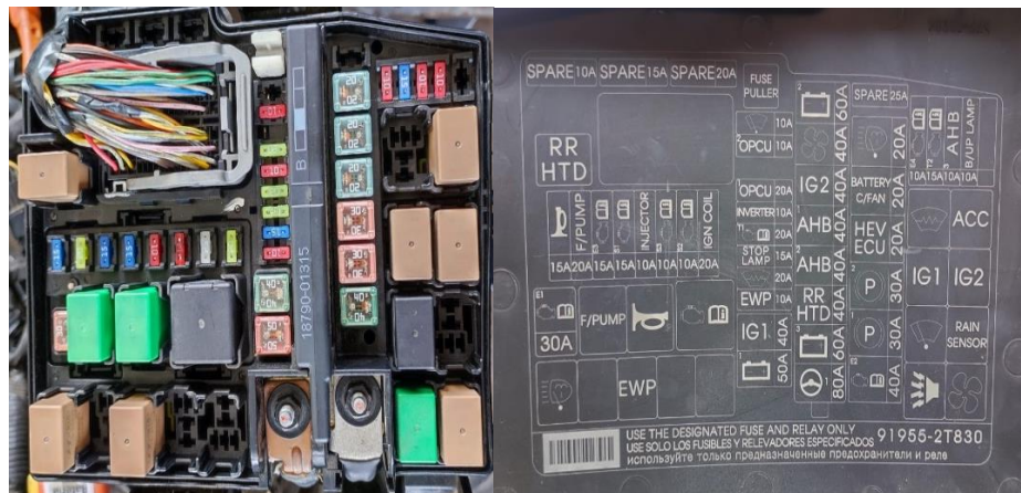
Figura 4.4 Fusibles, relés, conectores
