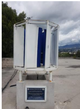
Figura 23 Generador eólico de baja potencia.
