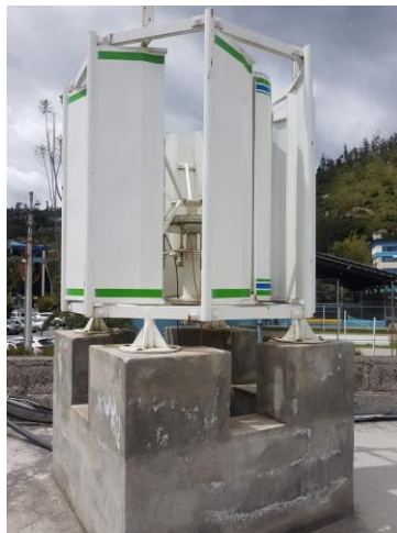
Figura 24 Sistema de micro generación eólica.
