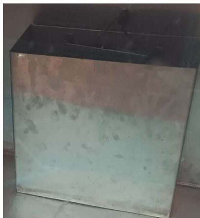
Fig. 57. Salida de los cables de los componentes de generación y distribución de neblina.
