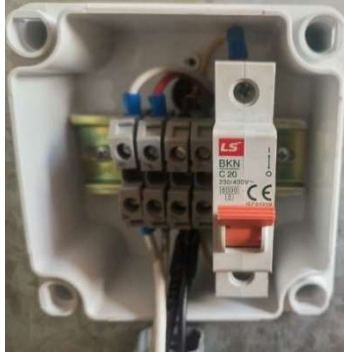
Fig. 54. Vista de las interconexiones.
