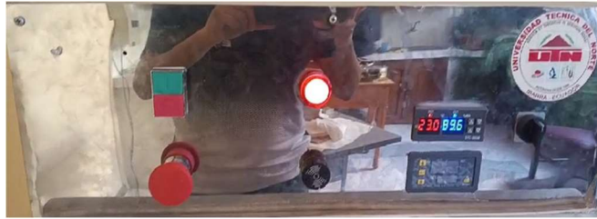
Fig. 59. Funcionamiento del tablero de control.
