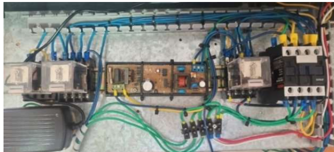
Fig. 55. Tablero eléctrico implementados los rediseños.
