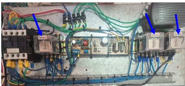
Fig. 58. Ubicación de los relés electromecánicos.
