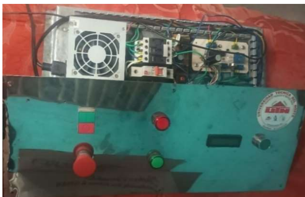
Fig. 33. Sistema eléctrico inicial, tablero eléctrico y panel de control.
