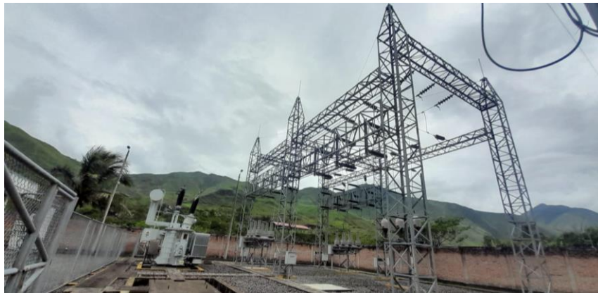
Figura 1. Subestación eléctrica La Carolina.
