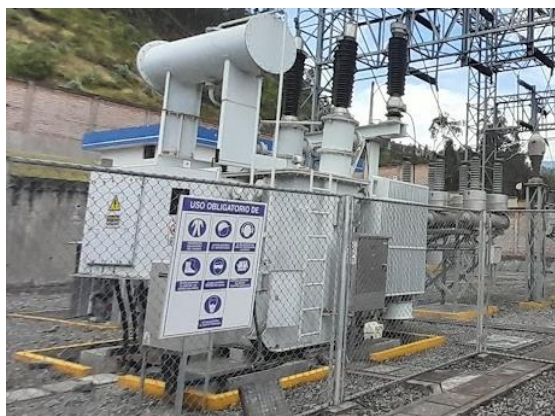
Figura 3. Transformador de la subestación San Vicente.
