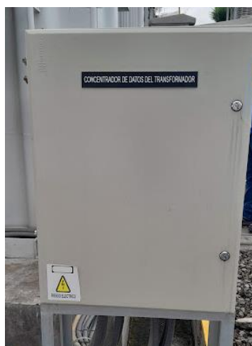
Figura 7. Concentrador de señales ubicado en la subestación San Vicente.
