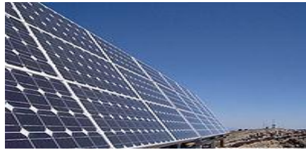
Grafico 2. 3 Central Fotovoltaica Fuente: www.energia3.mecon.gob.ar
