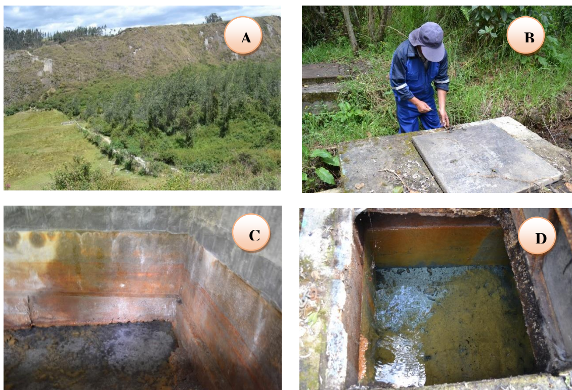
FIGURA 10: ÁREA DE LA FUENTE DE AGUA CONDOR LOMA. A. ÁREA DE FUENTES DE AGUA CONDOR LOMA DE PROPIEDAD DEL GAD MUNICIPAL DE COTACACHI; B. VERIFICACIÓN DE UNO DE LOS TANQUES DE AGUA CON APOYO DE UN FUNCIONARIO DEL GAD MUNICIPAL. C. TANQUE 1 DE ACUMULACIÓN DE AGUA. D. TANQUE 2 DE ACUMULACIÓN DE AGUA.
