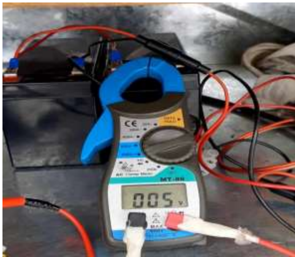
Figura 37 Conexión bancada de baterías
