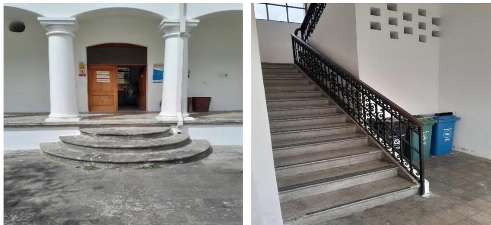
Figura 8. Circulación Peatonal – Vertical. Incumplimiento de otros parámetros de las escaleras. Imagen frontal y lateral
