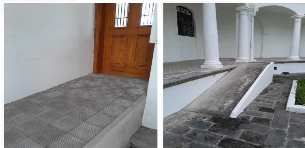
Figura 9. Evaluación de rampas según NEC-HS-AU: Accesibilidad Universal. Campus San Vicente de Paúl. 2024
