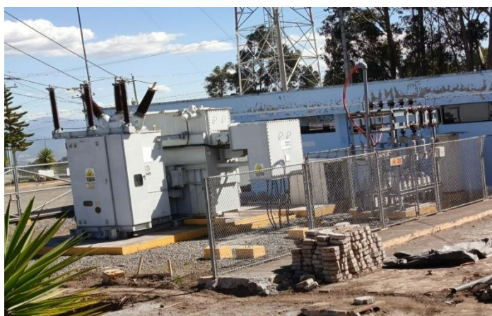
Fig 5. Subestación La Esperanza.
