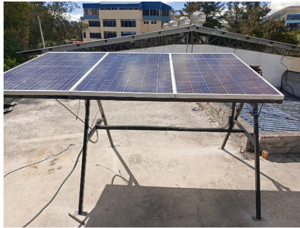
Fig. 19. Sistema fotovoltaico fijo.
