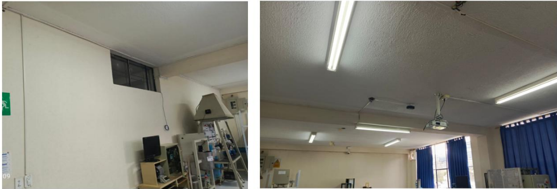
Fig. 36. Circuito de iluminación independizado.
