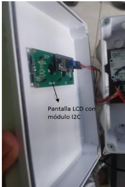
Fig. 43. Compuerta posterior del gabinete.
