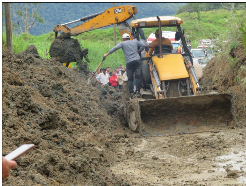
Vía de primer orden E10 inhabilitada por un deslizamiento
