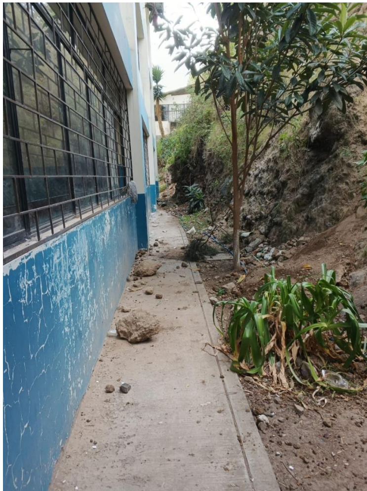
Figura 8. Movimiento de masas y escombros de muro del muro de tierra
