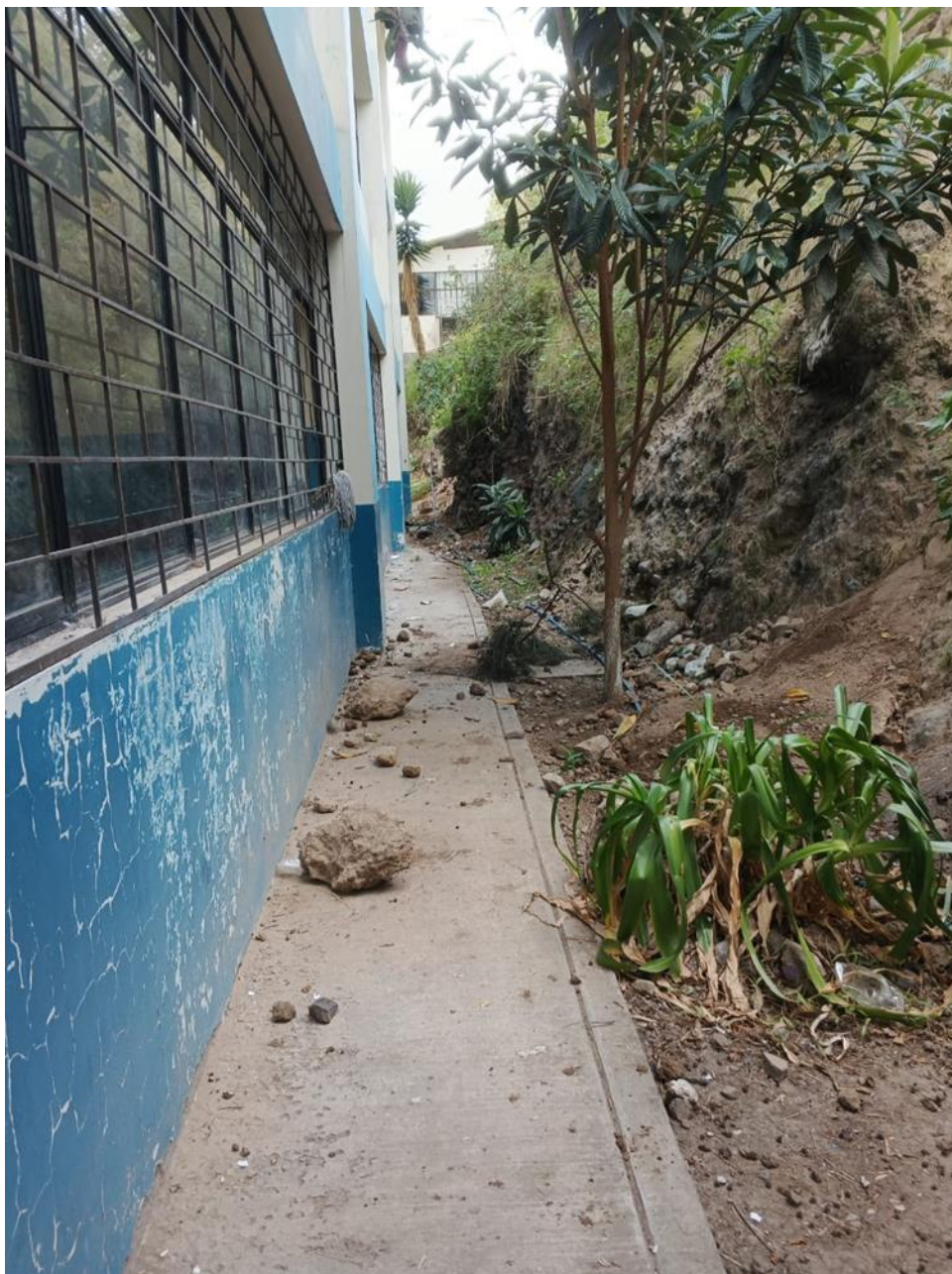
Colegio UTN-Pendiente de tierra con movimiento de masas-28/03/2024
