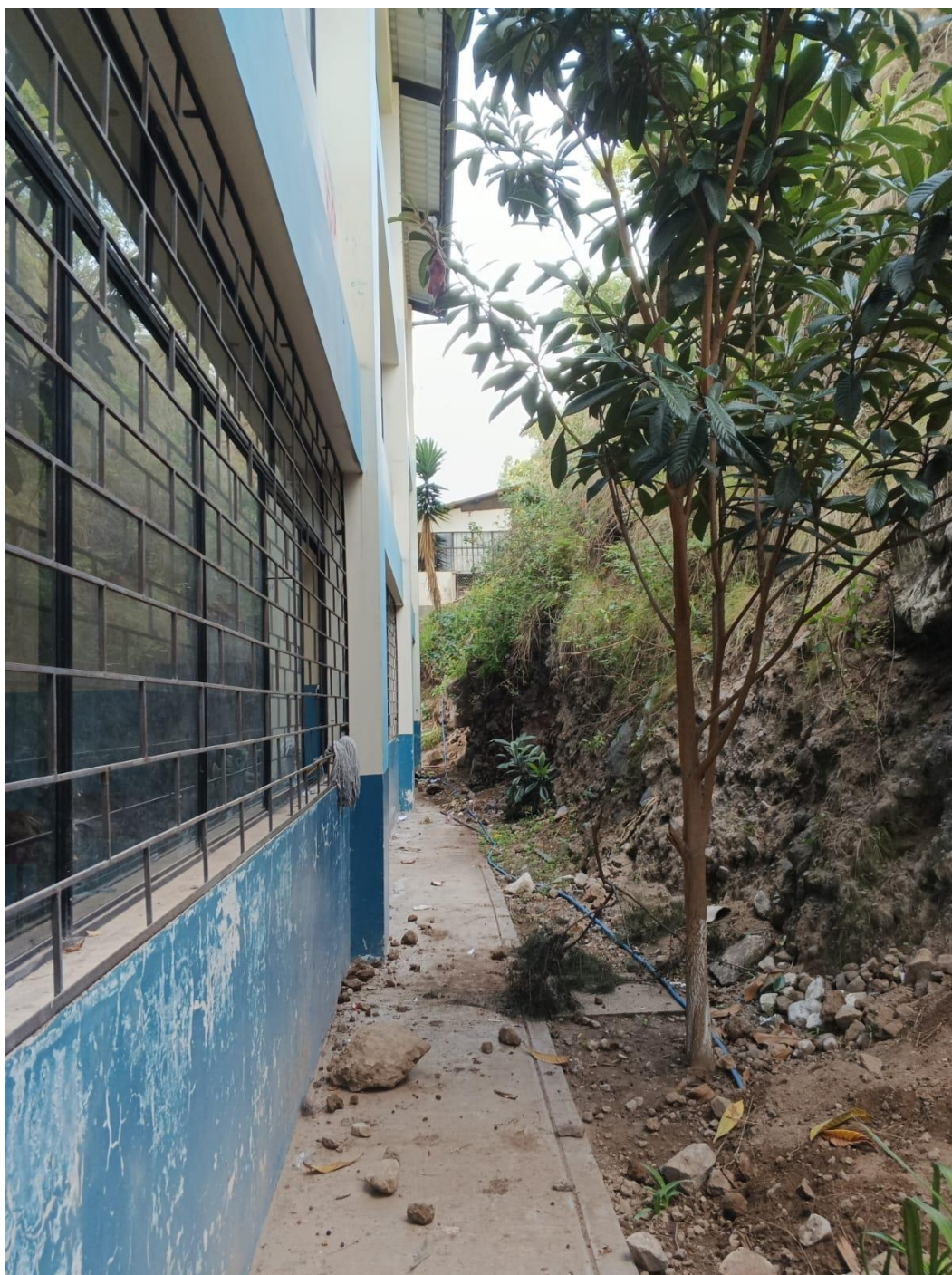
Colegio UTN detrás del bloque 2 de aulas - Pendiente de tierra con movimiento de masas
