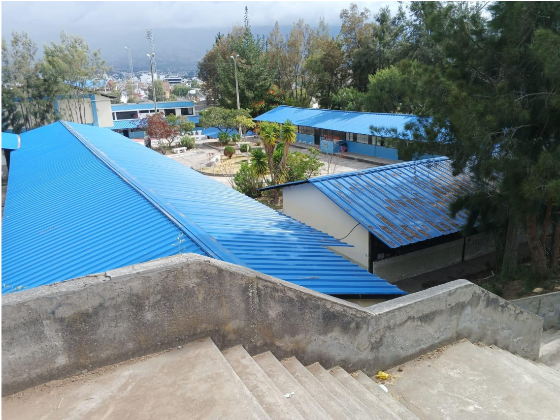
Colegio UTN detrás de aulas 5 en frente del patio secundario - Pendiente de tierra con piedras y un poco de follaje seco
