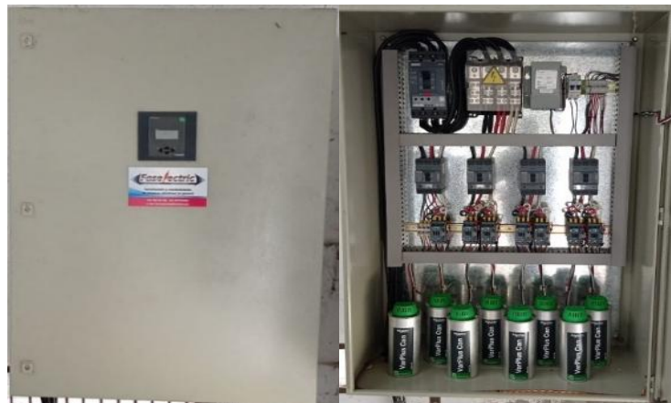
Fig. 14: Tablero de control de corriente del transformador de 300kVA. Fuente: Autor.
