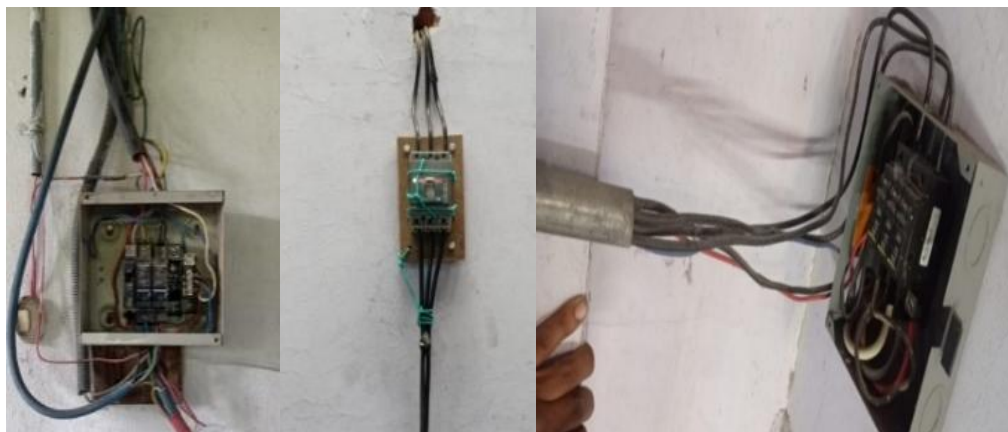
Fig. 19: Instalaciones internas de la industria. Fuente: Autor
