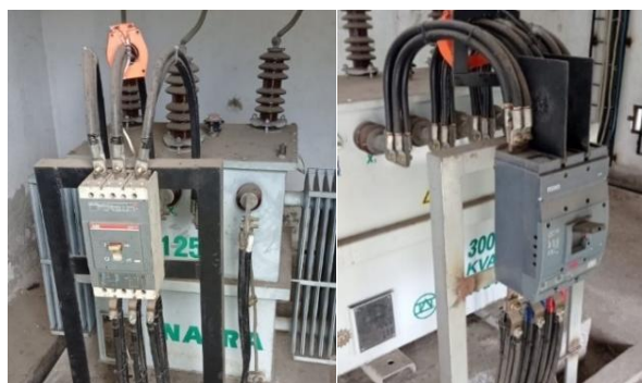
Fig. 8: Transformadores de 125 y 300kVA que posee la industria. Fuente: Autor.
