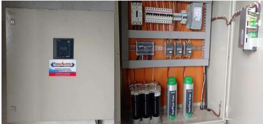
Fig. 13: Tablero de control de corrientes del transformador de 125kVA Fuente: Autor.
