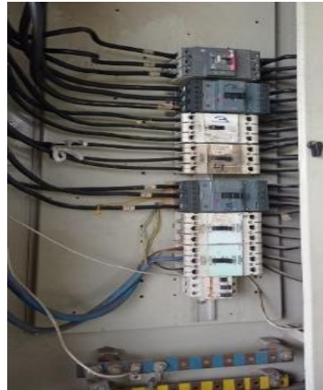
Fig. 11: Tablero principal del transformador de 125kVA. Fuente: Autor.
