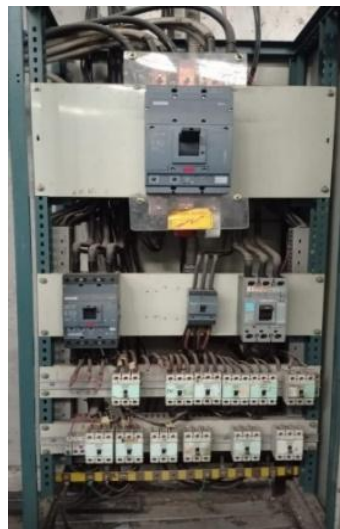
Fig. 12: Tablero principal del transformador de 300kVA. Fuente: Autor.
