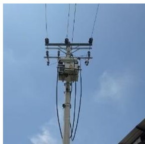
Fig. 9: Transformador de corriente (Trafomix) Fuente: Autor.
