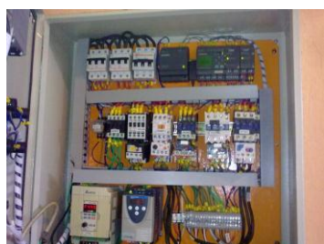
FIGURA 19. Tablero de Control
