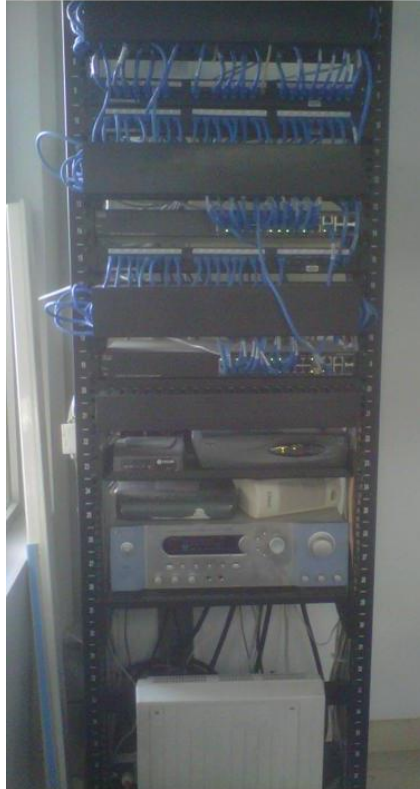
Figura 4.1. Rack con varios switch cisco Fuente: Archivo Comercial Hidrobo
