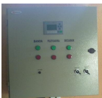
Figura 36: Caja de control implementada
