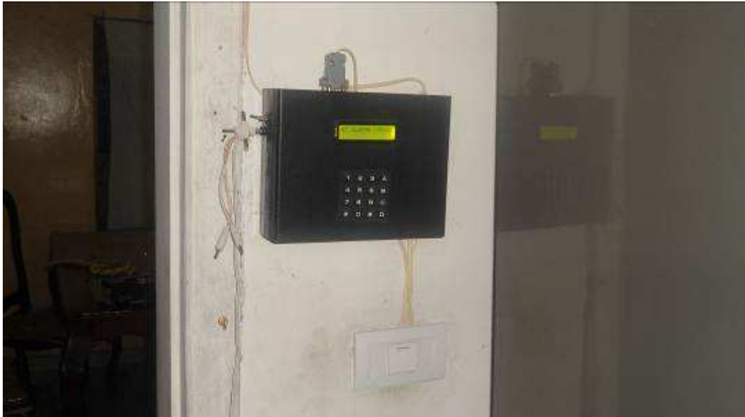
Fotografía 2.- SCA-XBEE amurado e instalado
