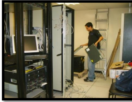
Figura 86 Cuarto de equipos GPI Fuente: GPI
