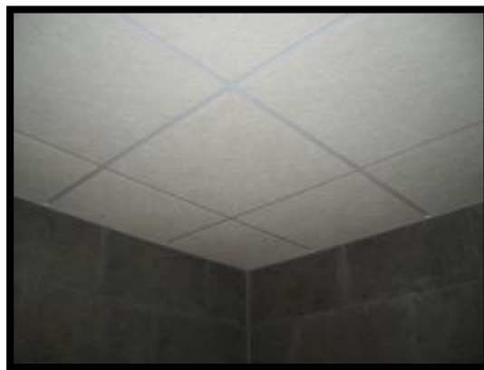
Figura 72 Techo falso con 15 módulos
