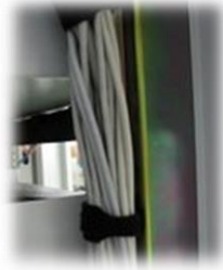
Figura 90 Cableado de Racks Fuente: GPI
