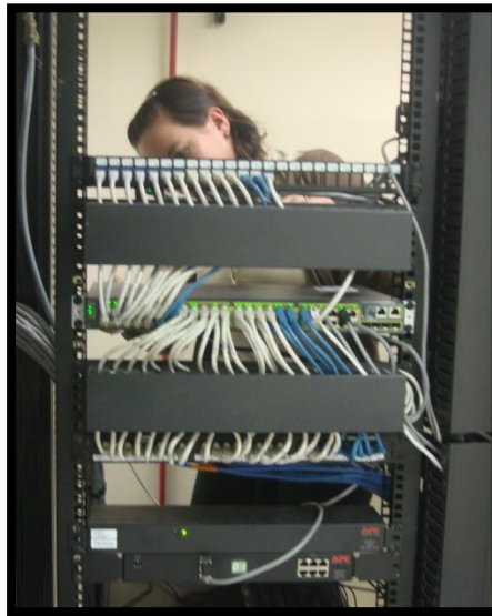
Figura 98 Patch Panel Fuente: GPI
