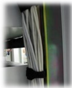
Figura 62 Cableado de Racks Fuente: http://icomintegration.mex.tl/
