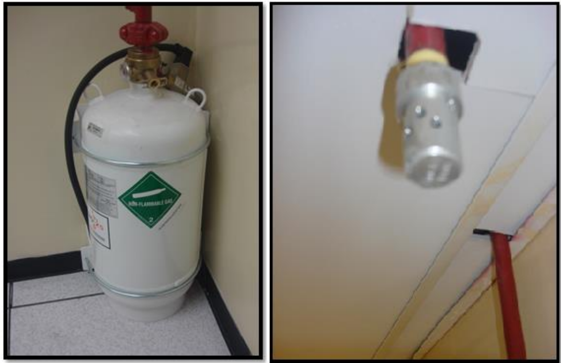
Figura 125 Cilindro de agente Ecaro 25 y tobera en el techo falso. Fuente: GPI
