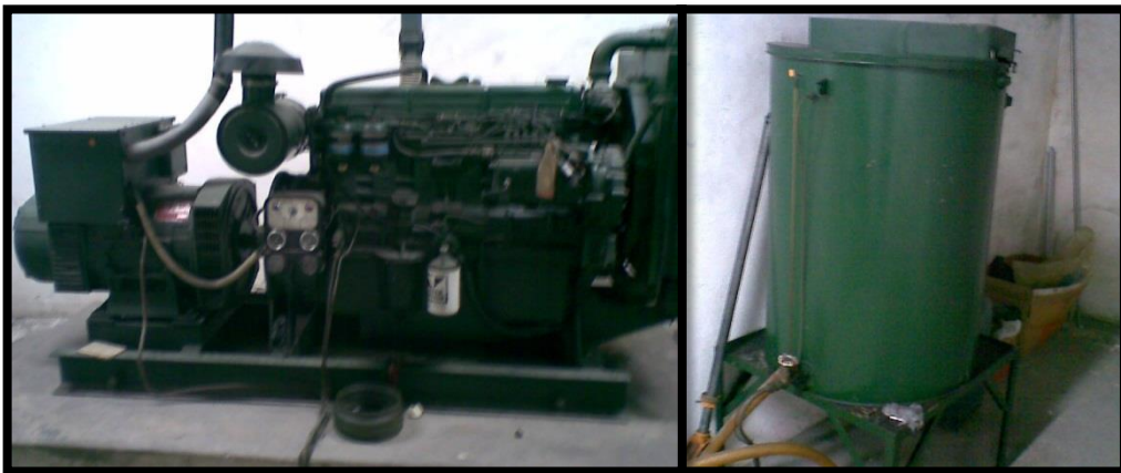
Figura 26 Generador y Tanque de diesel para su funcionamiento Fuente: GPI
