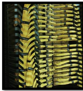
Figura 3 Cableado Modelo Fuente: GPI
