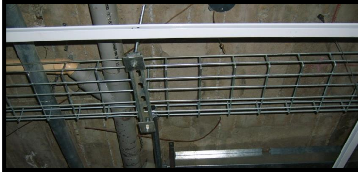
Figura 104 Detalles de Bandeja metálicas Fuente: GPI
