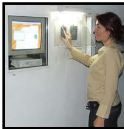
Figura 77. Control de acceso Fuente: GPI
