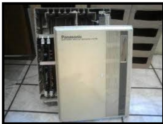
Figura 28 Central telefónica Panasonic KXT123210. Fuente: GPI.
