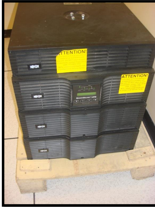
Figura 118. UPS de 8000 V Fuente: GPI
