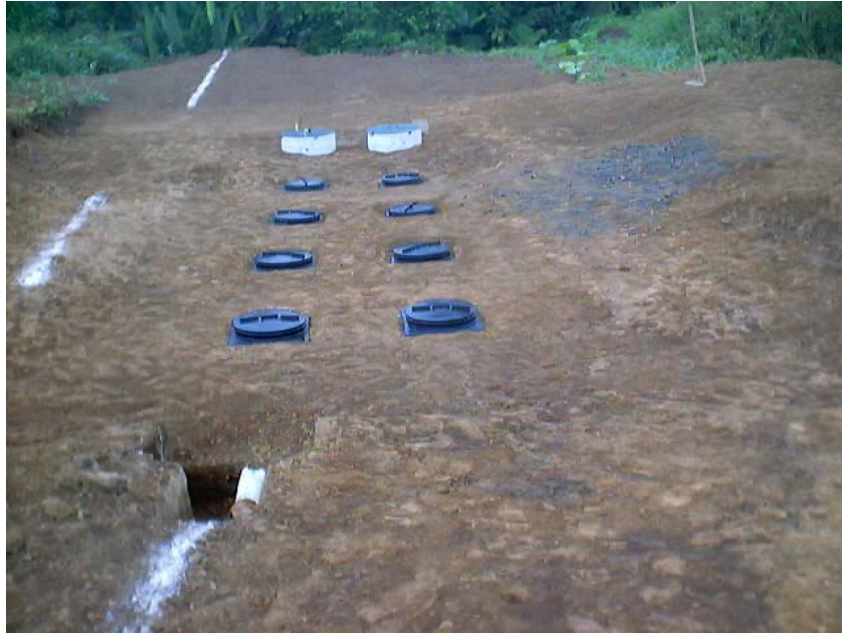
Pozos de Tratamiento de Aguas servidas
