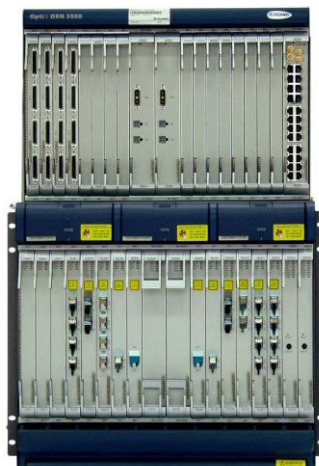
Figura 27. Equipo multiplexor OSN 3500. Fuente: Manual de Descripción de Hardware (Marzo, 2012) Recuperado de: http://www.datatel-ural.ru/huawei_docs/OSN_1500_2500_3500.pdf
