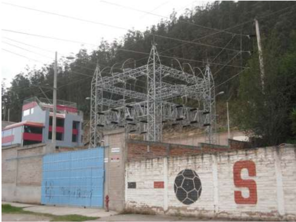
Fotografía 18. Estación Eléctrica ubicada en al Oeste del área de estudio.
