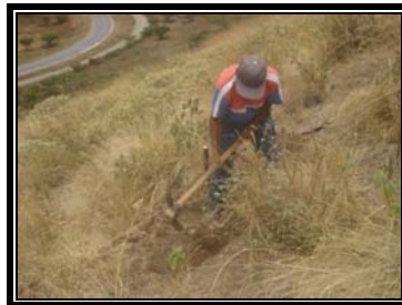
Fotografía 16. Apertura de zanjas de infiltración y hoyos en el sitio 3 (Robayo). Yahuarcocha. UTN, 2006-2007
