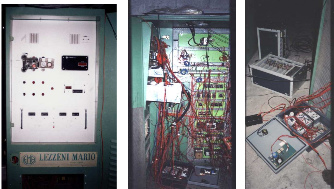
Fig. 80. Tablero de control
