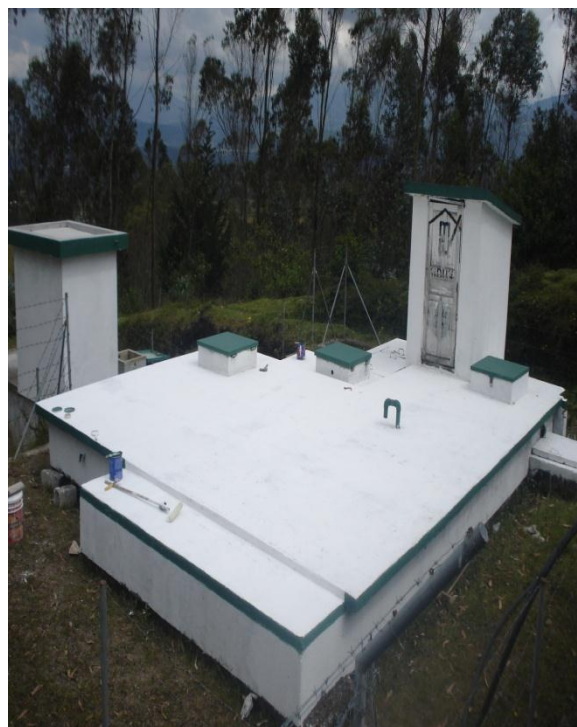
TANQUE DE ALMACENAMIENTO COMUNIDAD DE UGSHAPUNGO
