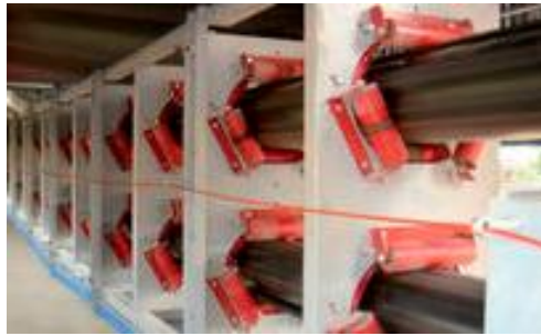
Figura 1.4. Banda transportadora tubular
