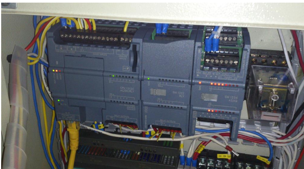
Figura 6.46. Tablero de control del PLC Fuente: Autores (Gabriela León, Germán Vaca)
