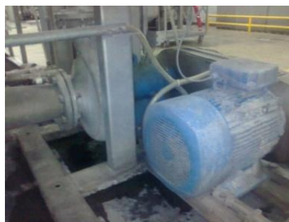
Figura N° 34. Bomba principal de circulación
