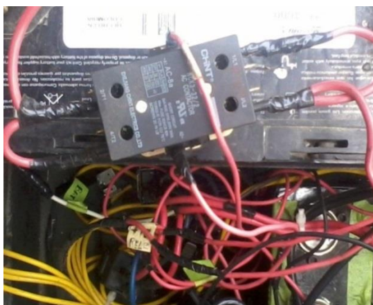
Figura 4.17. Contactor de 24V. Fuente. Autores.
