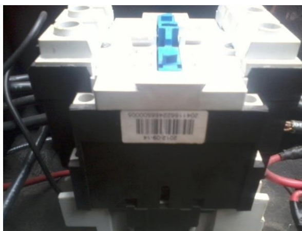
Figura 4.16. Contactor de 36V. Fuente. Autores.
