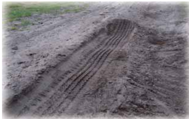
Figura N° 31. Hump" del material de revestimiento.
