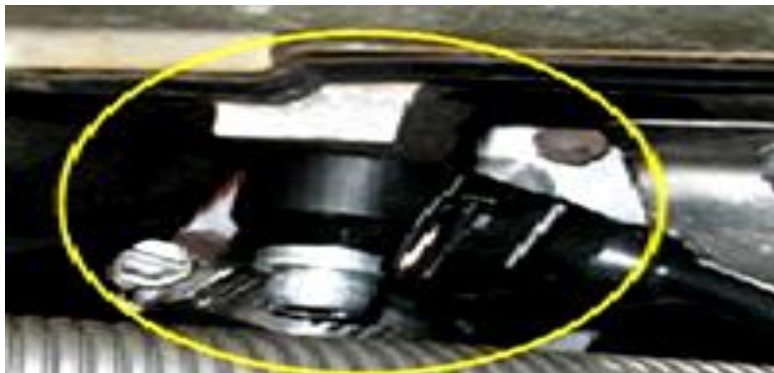
Figura. 23 Sensor KS Ubicado.
