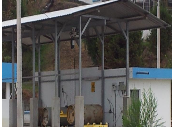
Fotografía 21.3: Contenedores de Cloración (Cloro gas) (junio, 2012)
