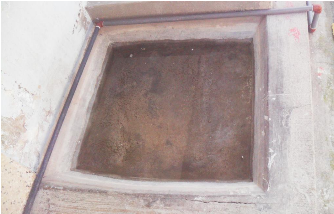
POSA DE AGUA DE DESINFECCIÓN
