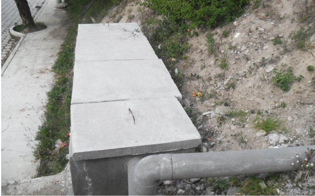
TRATAMIENTO DE AGUAS
