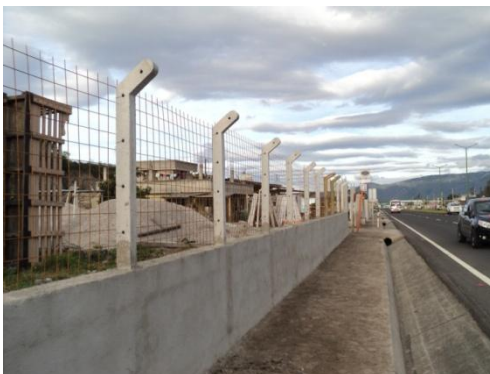
Fotografía 1.9 Cerca de una casa con postes de hormigón armado para alambrado perimetral.
