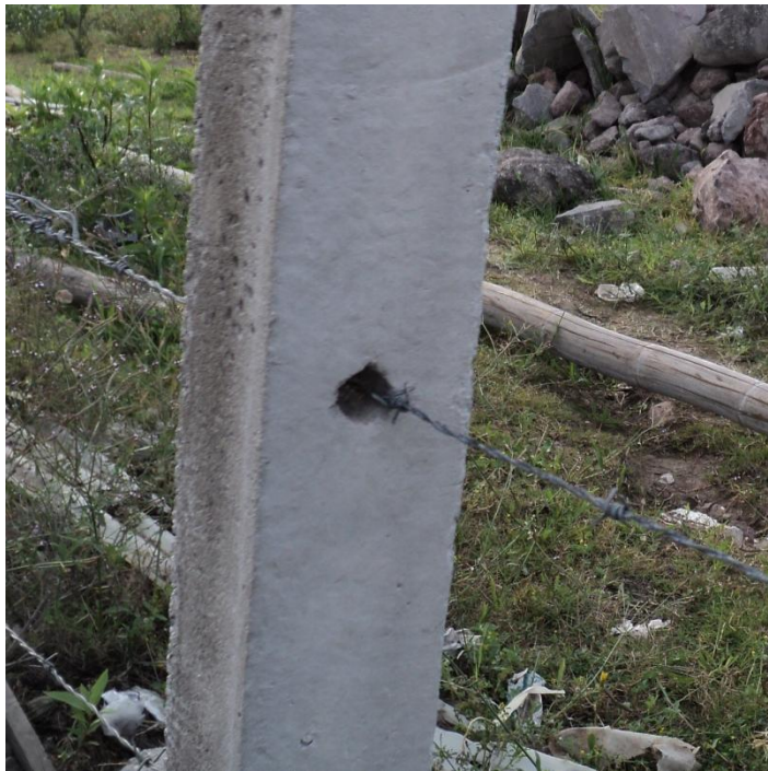
Fotografía 5.8 Orificio del poste fabricado en la máquina, después del paso del alambre de púas
