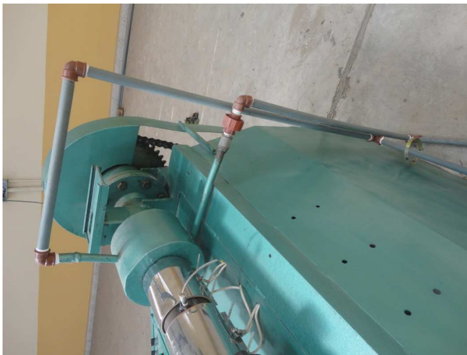
Figura A10.6. Ingreso de agua para refrigeración de la garganta de alimentación.
