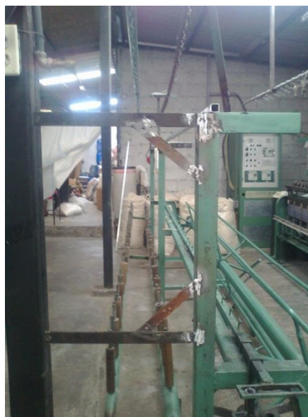
Figura 75. Marco metálico de soporte del tablero de control
