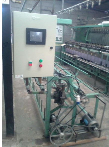
Figura 76. Tablero de Control Instalado
