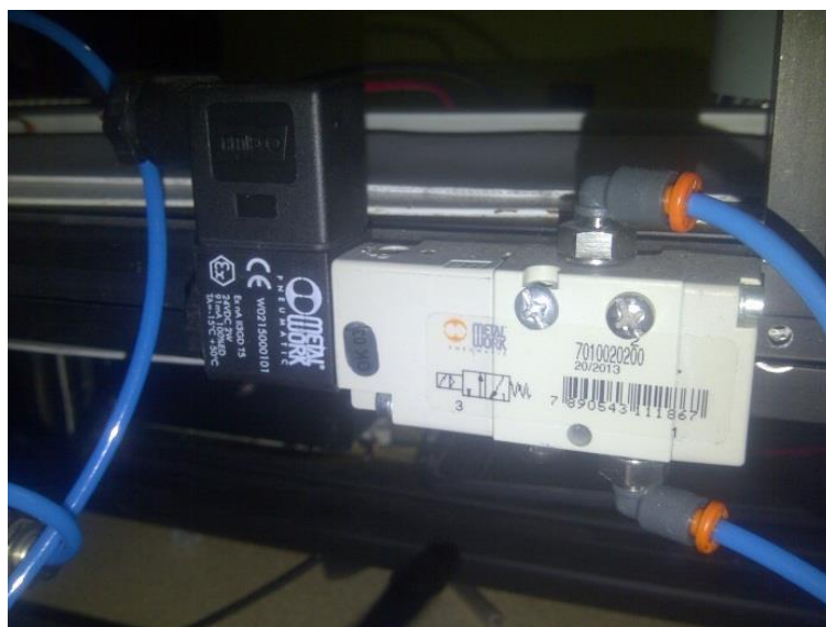
Figura 33. Electroválvula 3/2 para el accionamiento del cilindro de ingreso de piezas Fuente: Autor
