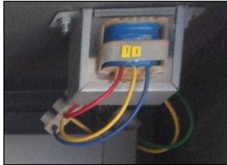
Figura 41: Transformador de 24 Vac
