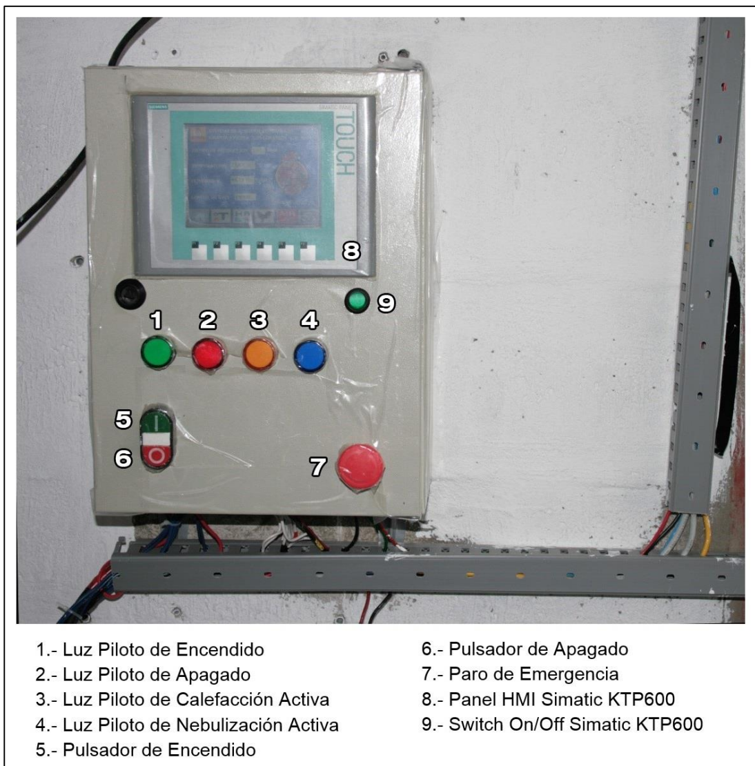
Ilustración 1.-Tablero de Control - Vista Frontal
