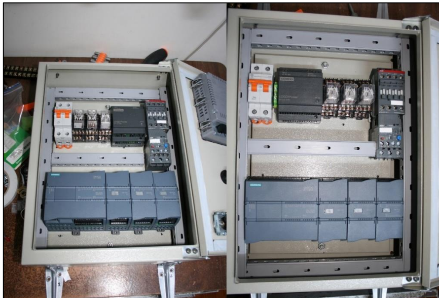
Figura 54.-Ubicación de Dispositivos Internos y Canaletas
