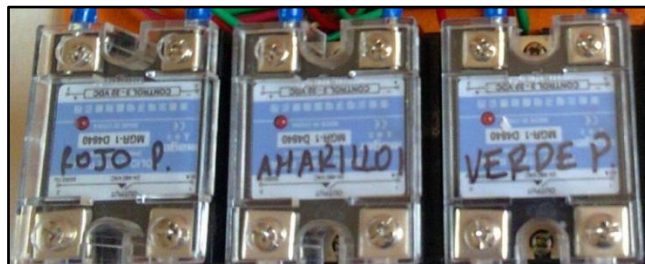
Figura 25. Relevadores de estado sólido. Fuente: Fotografía tomada a los SSRs.
