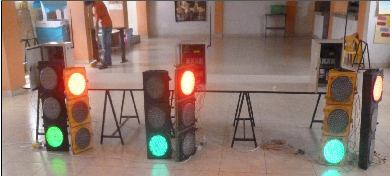
Figura 57. Sistema de Semaforización trabajando en modo Normal. Fuente: Fotografía tomada al sistema de semaforización en funcionamiento
