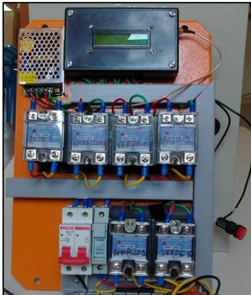
Figura 54. Montaje de los SSRs y la fuente. Fuente: Fotografía tomada al montaje del sistema.
