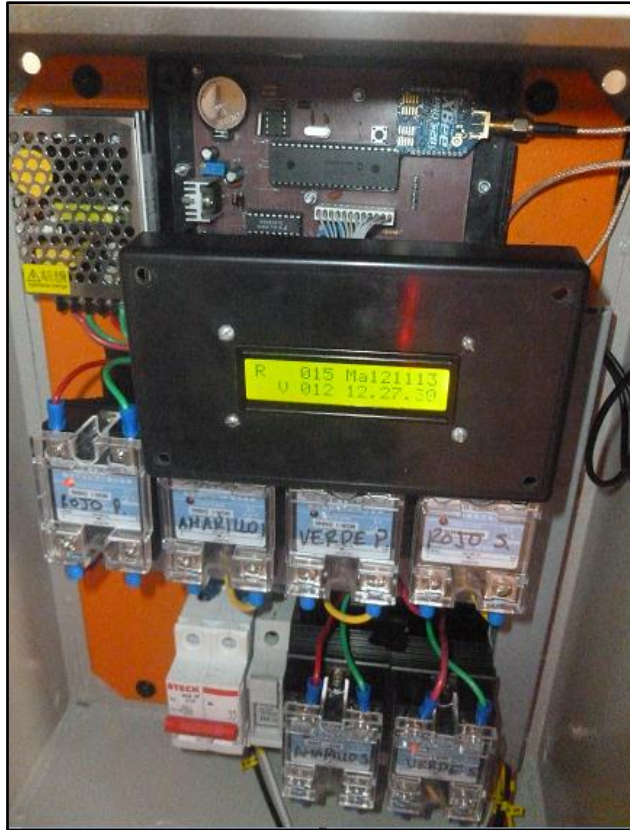
Figura 55. Montaje final del proyecto de semaforización con todos sus elementos. Fuente: Fotografía tomada al sistema de semaforización.
