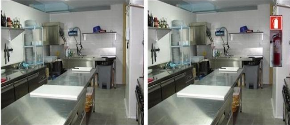
Extintor número 3 (en el área de cocina)
