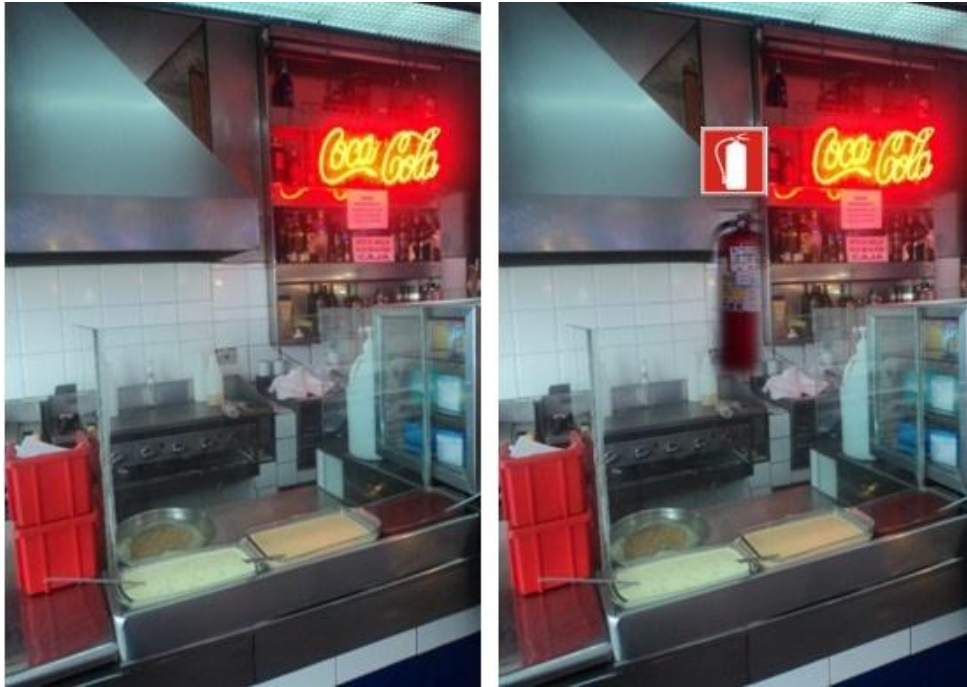
Extintor número 1 (cerca al despacho de alimentos)
