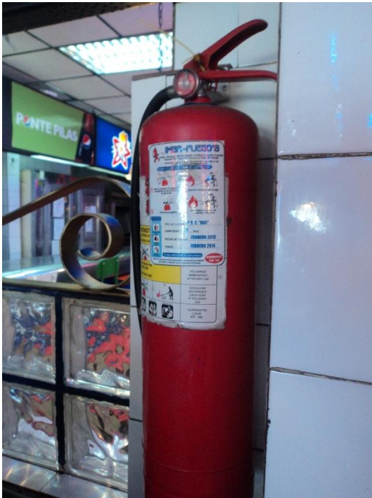
Extintor de uso de la empresa (Tipo de carga PQS "ABC" de 20 libras).
