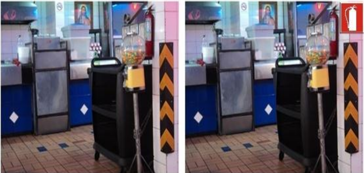
Extintor número 2 (a lado de la entrada a la sala de juegos infantiles)
