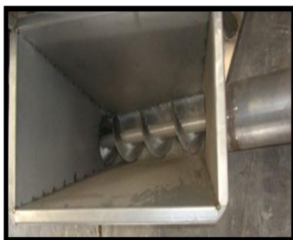
Figura 22. Alimentación del bagazo al caldero
