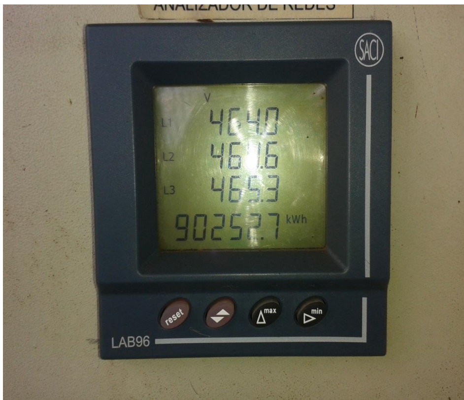
Figura 20. Analizador de redes eléctricas SACI.
