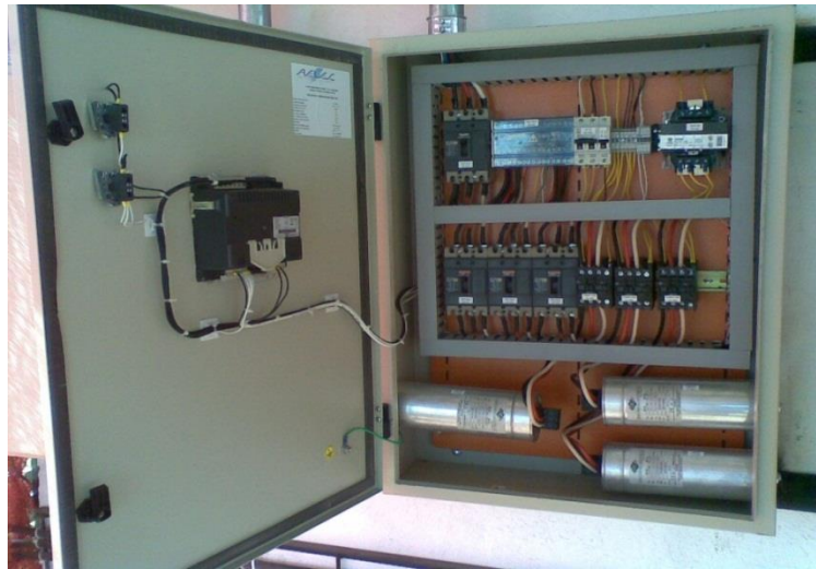
Figura 28. Tablero banco de condensadores.
