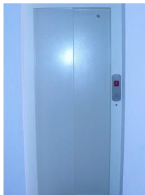
Figura 5. Puerta de piso
