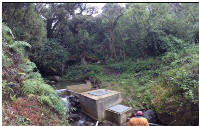
Figura 2.3 Captación de aguas superficial JAAP El Ejido Elaboración: La autora
