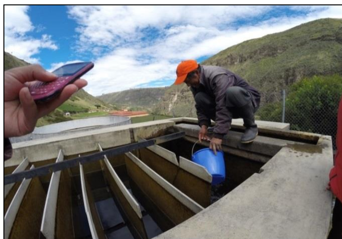
Figura 3.16 Aforo de caudal que ingresa a la planta de tratamiento JAAP Gruta la Paz
